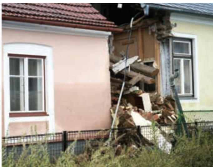
Gebäudeschaden durch Hochwassereinwirkung Hadersdorf am Kamp, Hochwasser 2002
