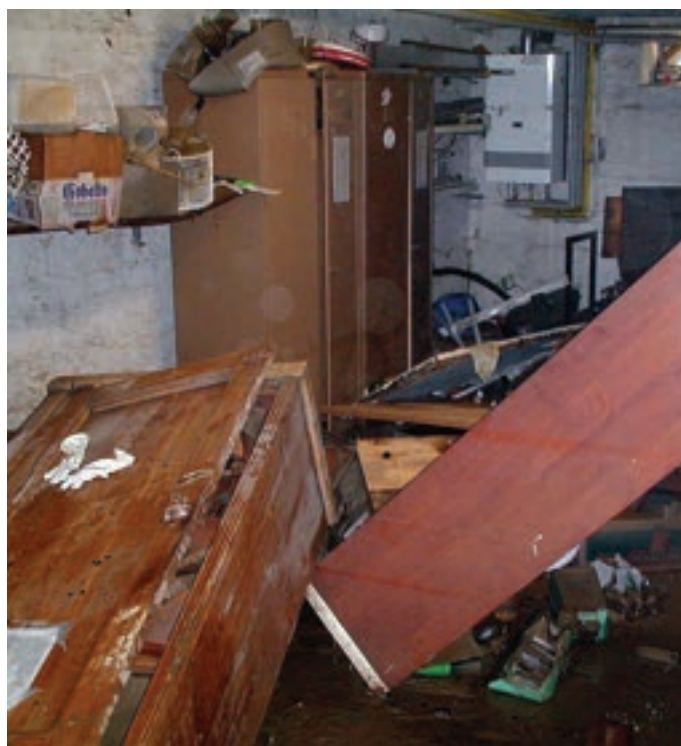
Keller nach dem Hochwasser 2002 in Hadersdorf-Kammern
